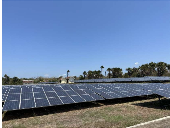
Gambar 1. Pembangkit Listrik Tenaga Surya (PLTS)
